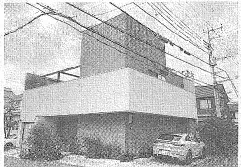
端正な建物だが、L字側溝の損耗が激しい
