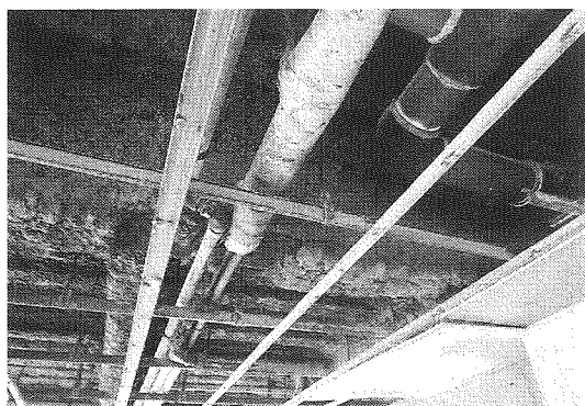
耐火被覆材料が分からない現実がある
